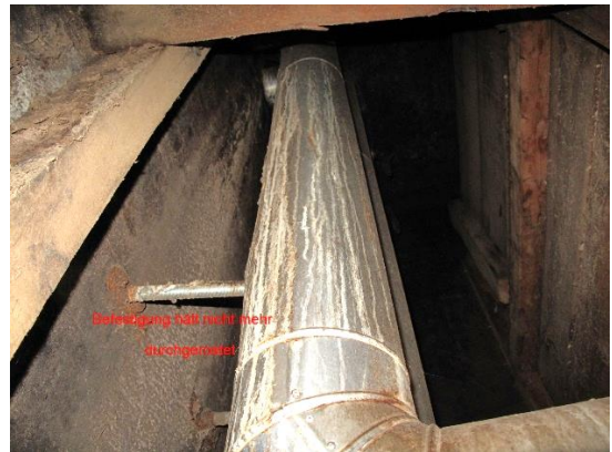
Steigschacht im Silo Befestigungen sind durchgerostet.
